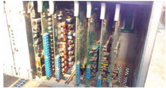
内部まで泥にまみれたデジタル電話交換機 (7/27)
